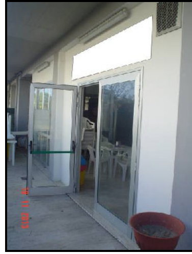
Foto 8 – Ingresso alla porzione di portico chiuso con una veranda priva di titolo edilizio
