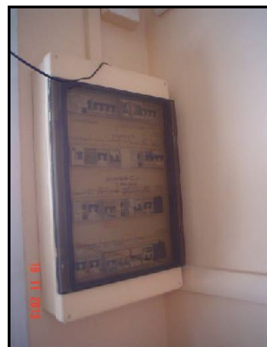
Foto 24 – Particolare quadro elettrico
