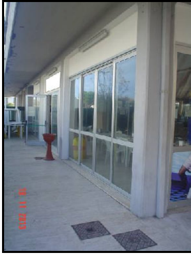
Foto 7 – Porzione di portico chiuso con una veranda priva di titolo edilizio
