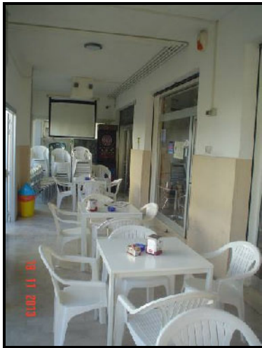
Foto 9 – Veduta interna della porzione di portico chiuso con una veranda priva di titolo edilizio
