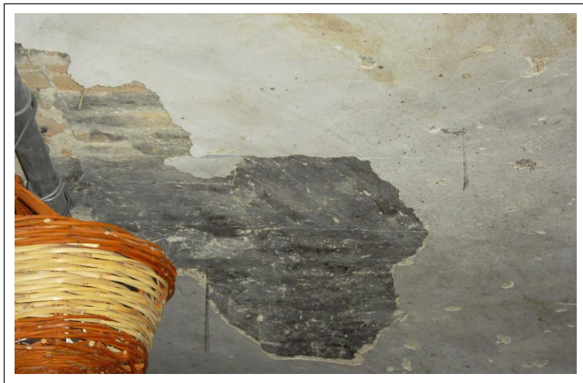
FOTO 12 particolare distacco intonaco su volta
