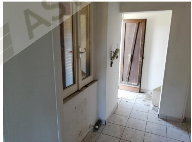
Foto 2b: ingresso abitazione con intonaco caduto;
