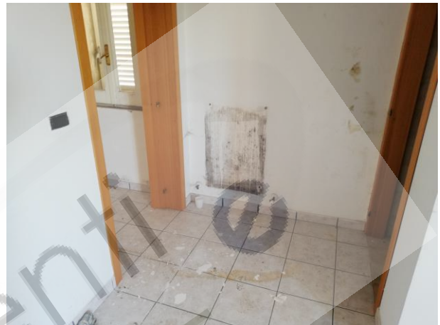
Foto 1b: presenza di intonaco caduto;
