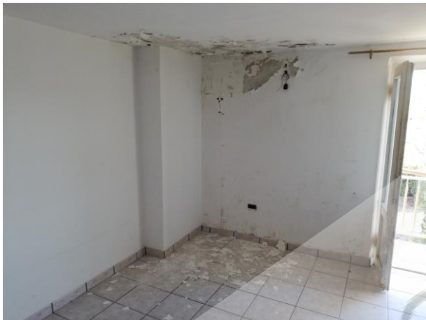
Foto 1a: lesioni su murature portanti ed intonaco caduto;
