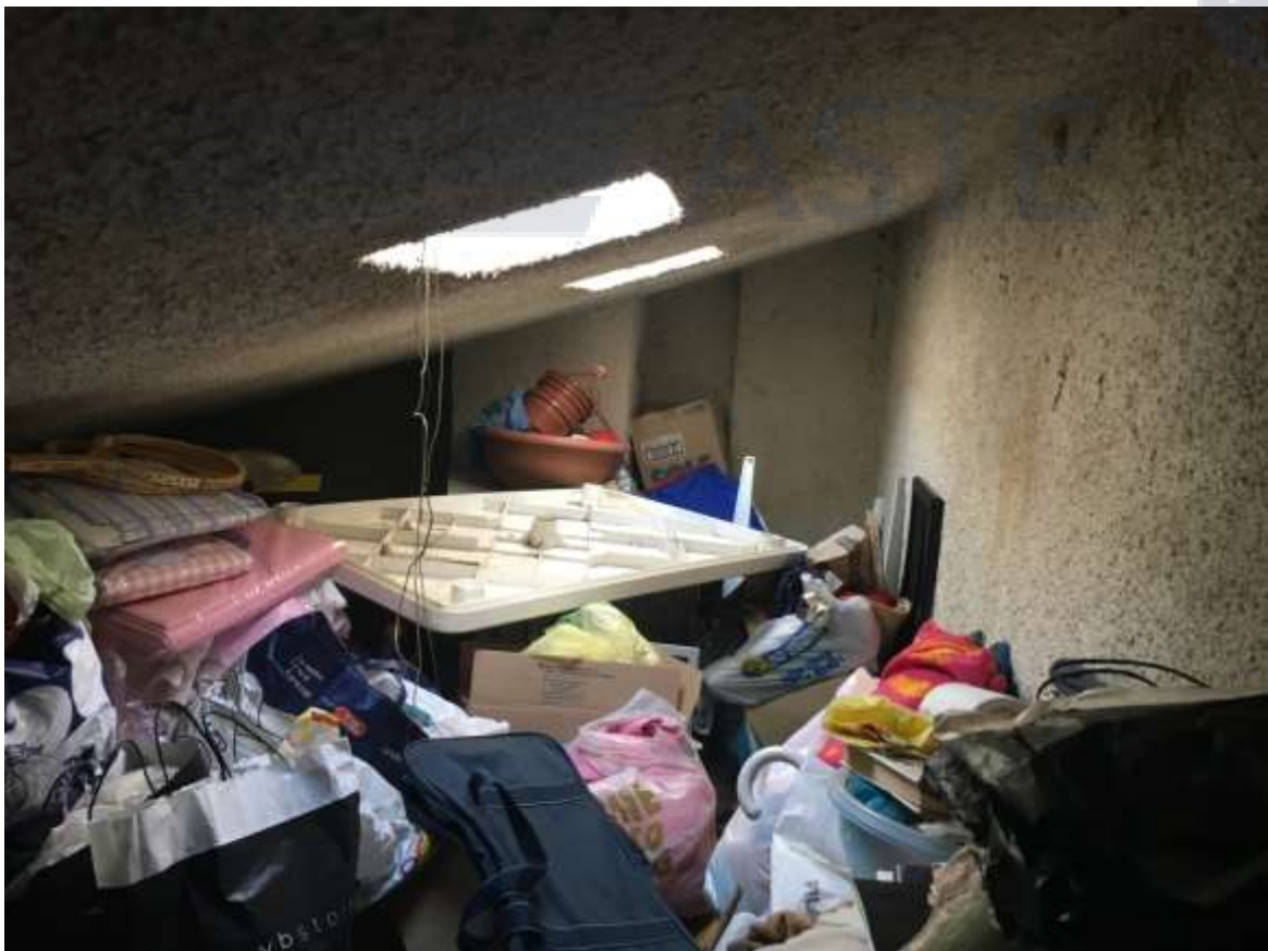
Foto n.16 – Vista interna Sub.13
