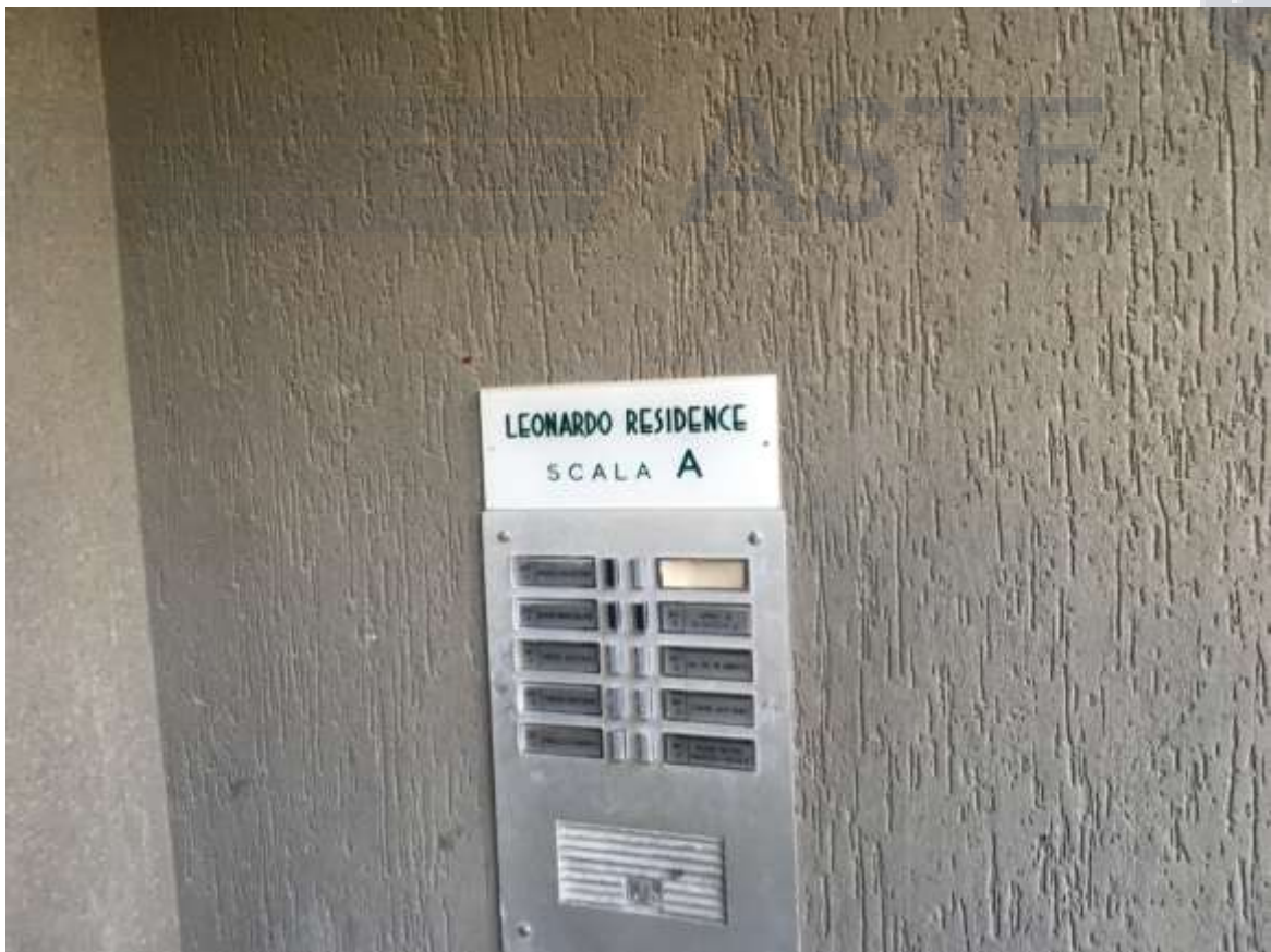
Foto n.10 – Vista esterna – Citofono Sub.13
