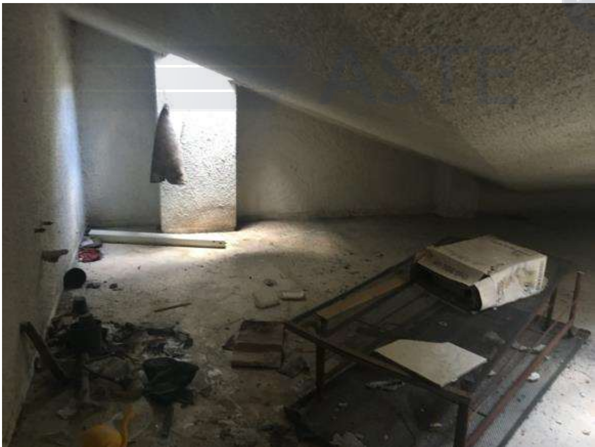
Foto n.12 – Vista interna Sub.26
