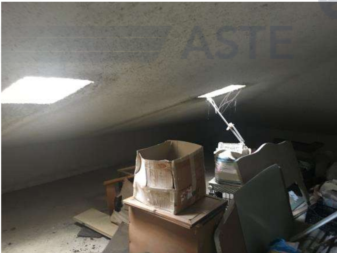
Foto n.14 – Vista interna Sub.26
