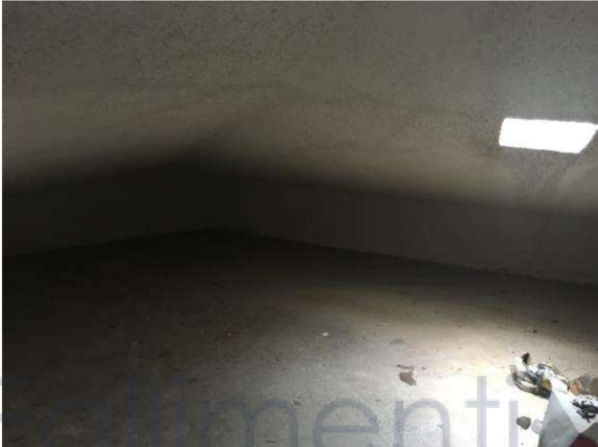
Foto n.13 – Vista interna Sub.26
