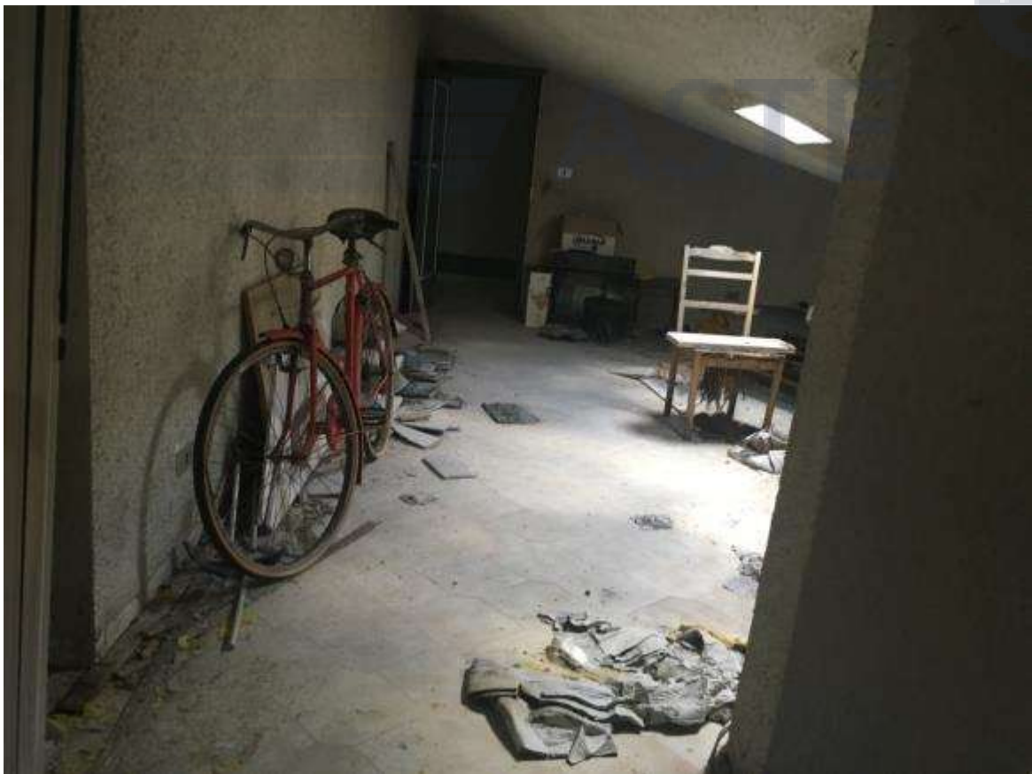
Foto n.18 – Vista interna Sub.26
