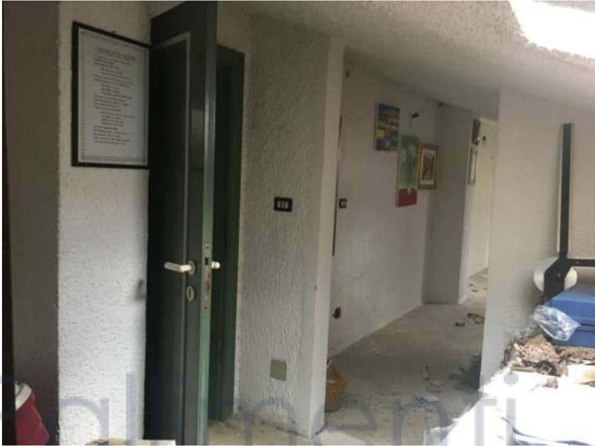
Foto n.13 – Vista interna Sub.29
