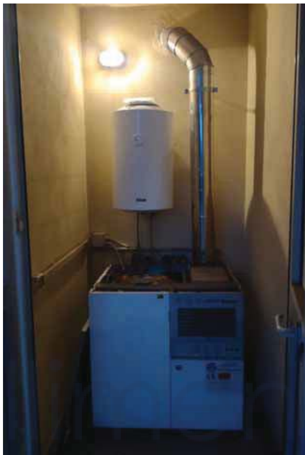
Foto n.23- Caldaia a gas
