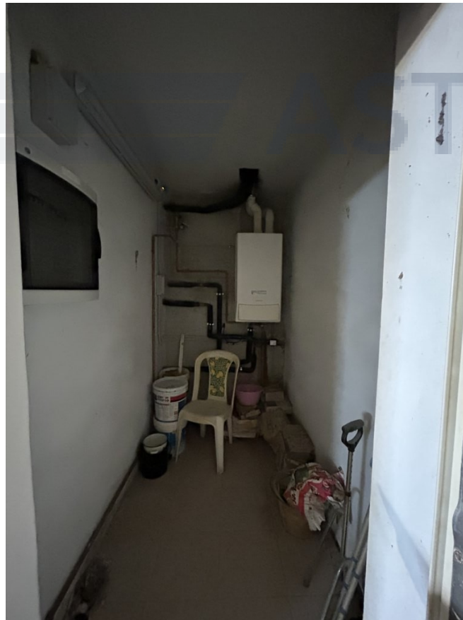
Foto 08 – C.T. piano seminterrato
