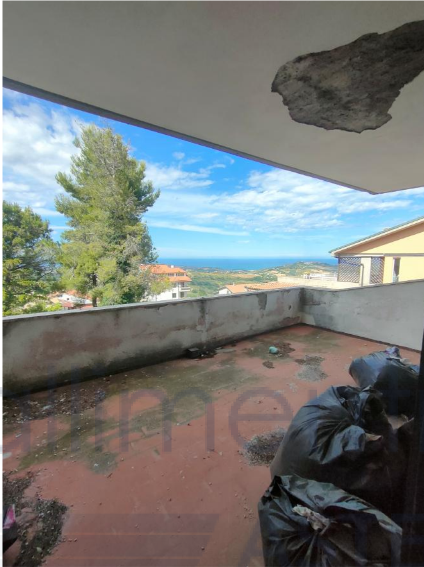
FOTO PARAPETTI TERRAZZO PIANO PRIMO – ASSENZA DI MANUTENZIONE (particolare scrostamento verniciatura e distacco intonaco dal cornicione)
