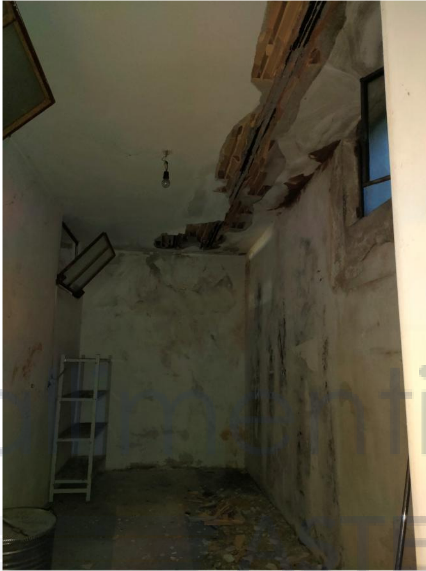
FOTO LOCALE INTERRATO – PROBLEMI INFILTRAZIONI (sfondellamento solaio)
