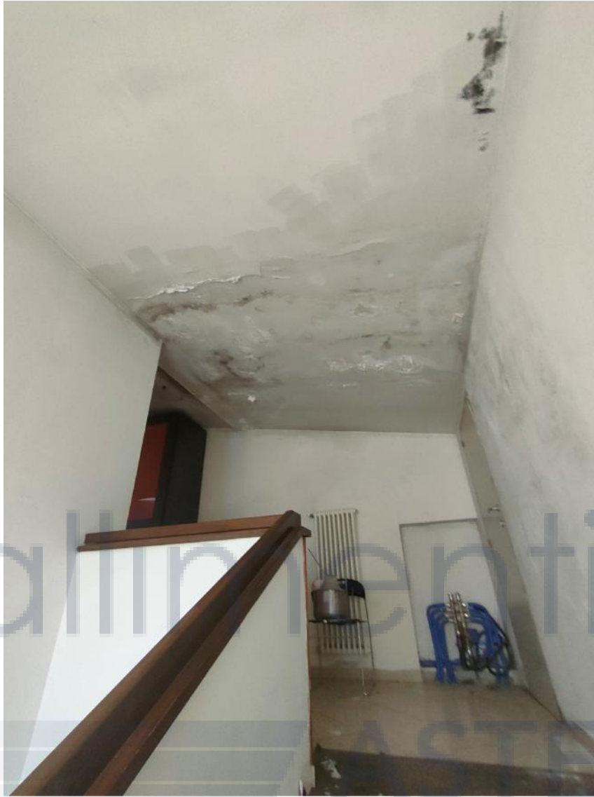
FOTO SOFFITTA PIANO SECONDO (PROBLEMI INFILTRAZIONI)
