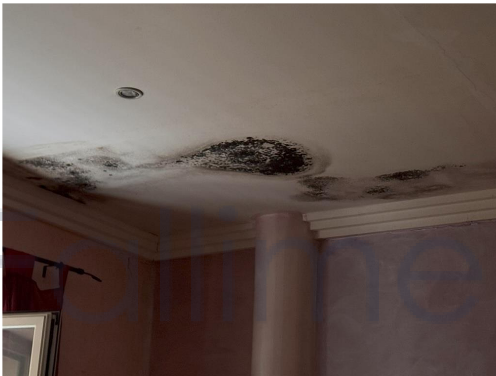
21. Vista dell'ammaloramento della controsoffittatura della camera
