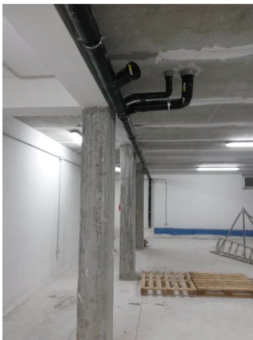
Vista interna sub 1
