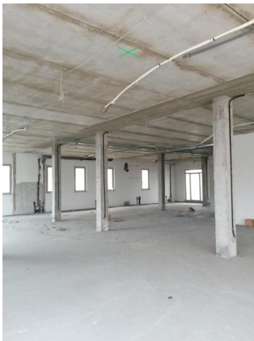
Vista interna sub 54
