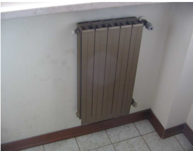
Particolare Elementi Radianti
