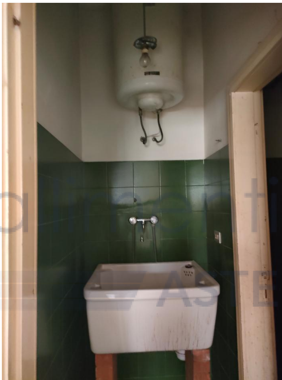
Vista Antibagno con boiler acqua calda
