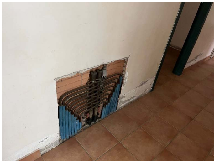
FOTO 85 Vista collettore su disimpegno spogliatoi
