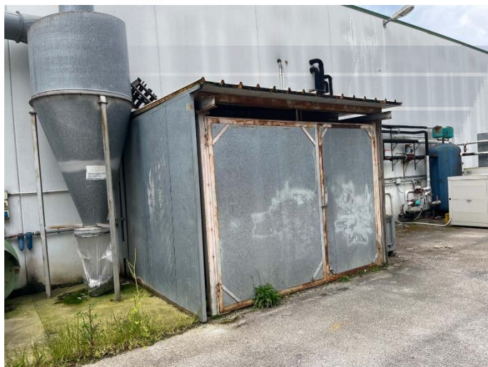
FOTO 11 Vista impianti su lato Nord
