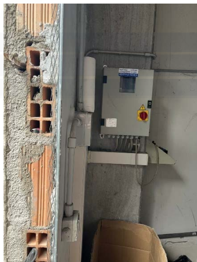
FOTO 127 Vista interno locale C.T.
