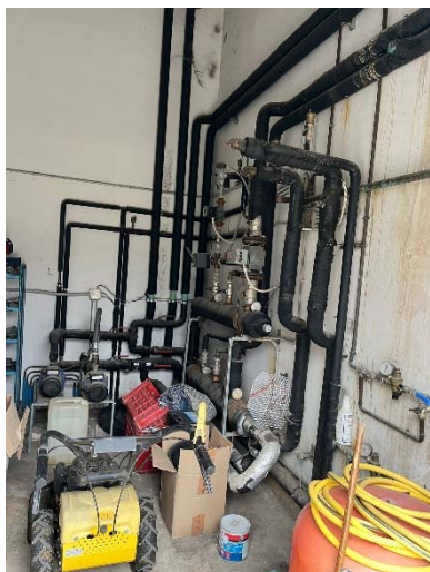
FOTO 129 Vista interno locale C.T.
