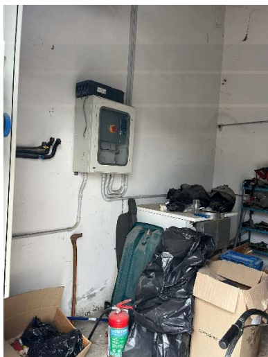
FOTO 131 Vista interno locale C.T.
