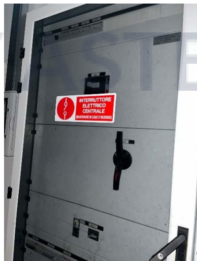
FOTO 64 Vista Quadro Elettrico
