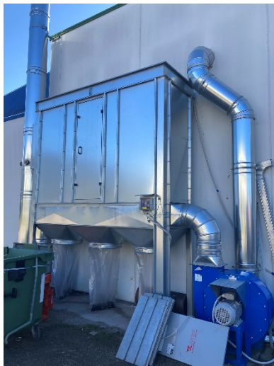
IMPIANTO DI ASPIRAZIONE (FILTRO A MANICHE)
