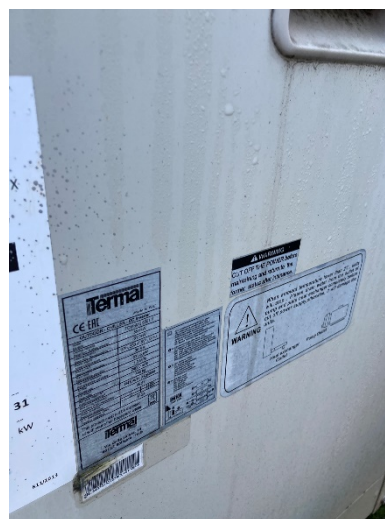
TARGA CE IMPIANTO CONDIZIONAMENTO
