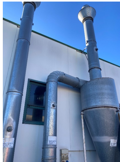
IMPIANTO DI ASPIRAZIONE (CICLONE)
