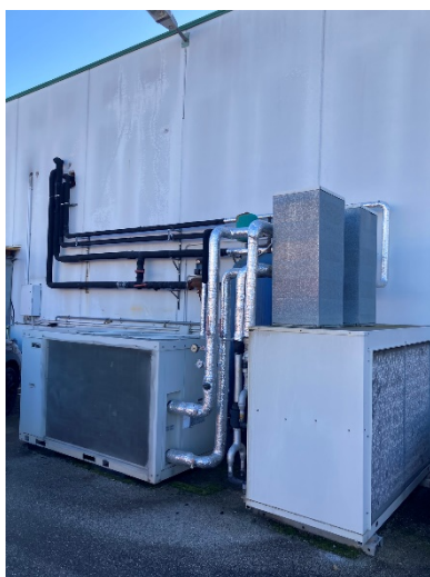
IMPIANTO DI CONDIZIONAMENTO (CHILLER)
