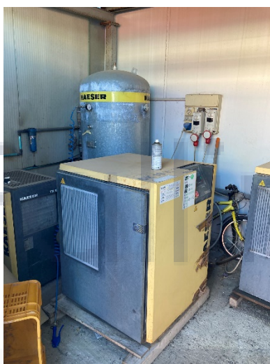
COMPRESSORE – ESSICCATORE ARIA - SERBATOIO
