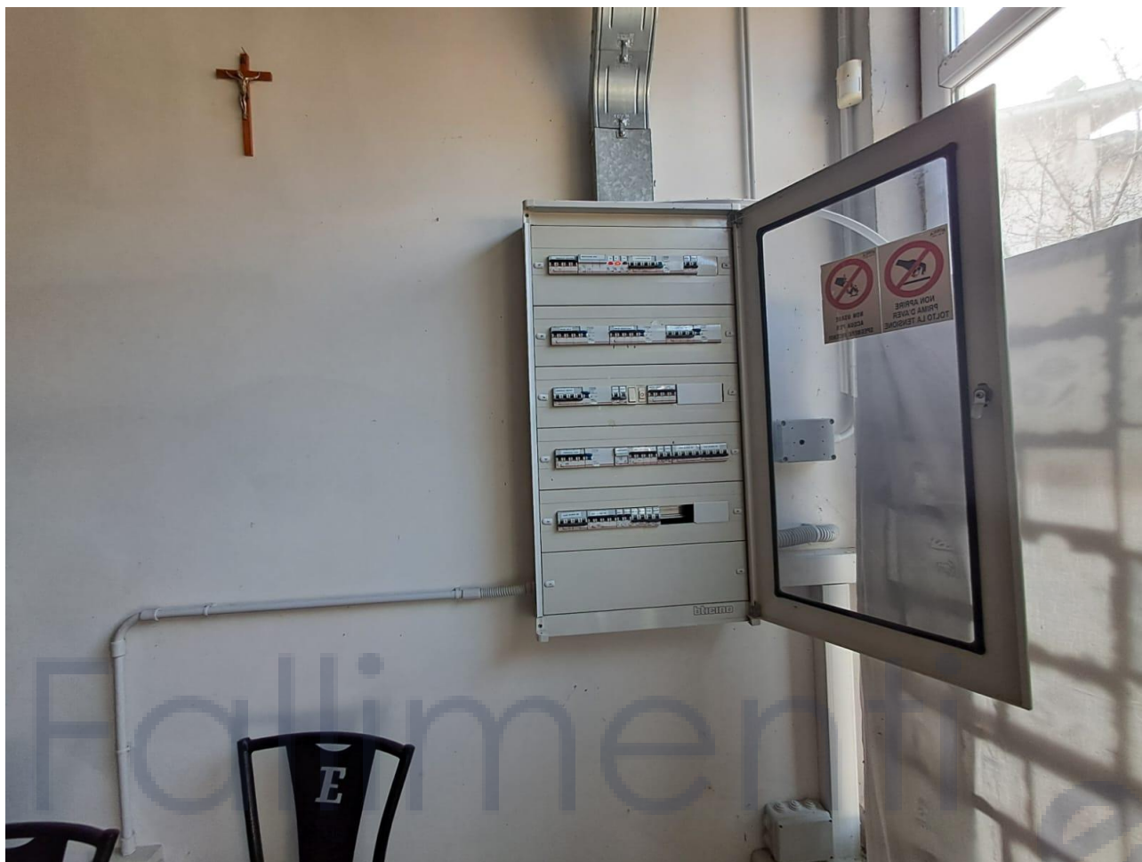
Foto 7: PART.LLA 292 QADRO ELETTRICO.
