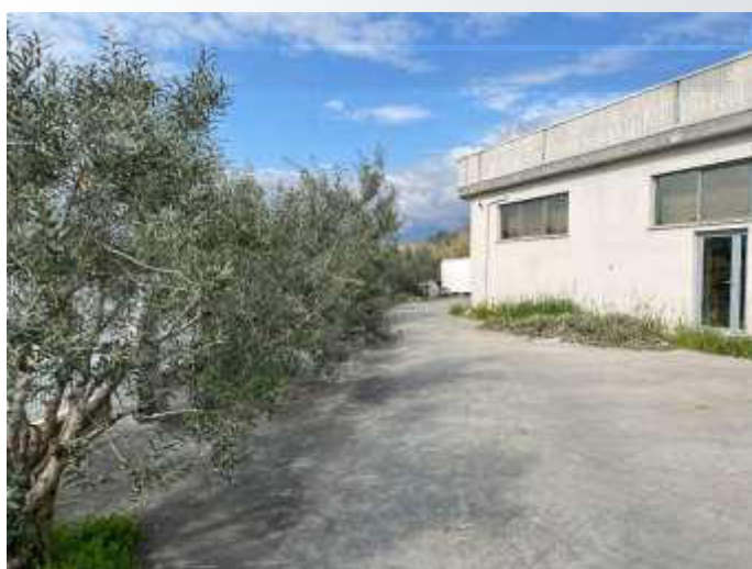
FOTO 87 Vista criticità lato sud
