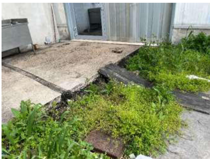
FOTO 73 Vista criticità lato sud
