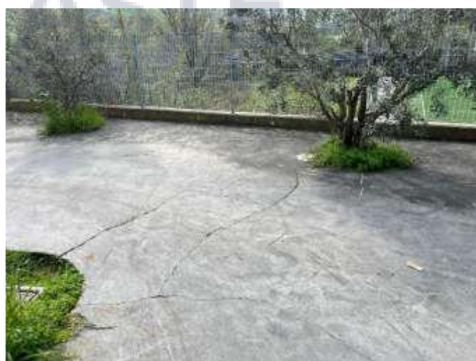
FOTO 88 Vista criticità lato sud
