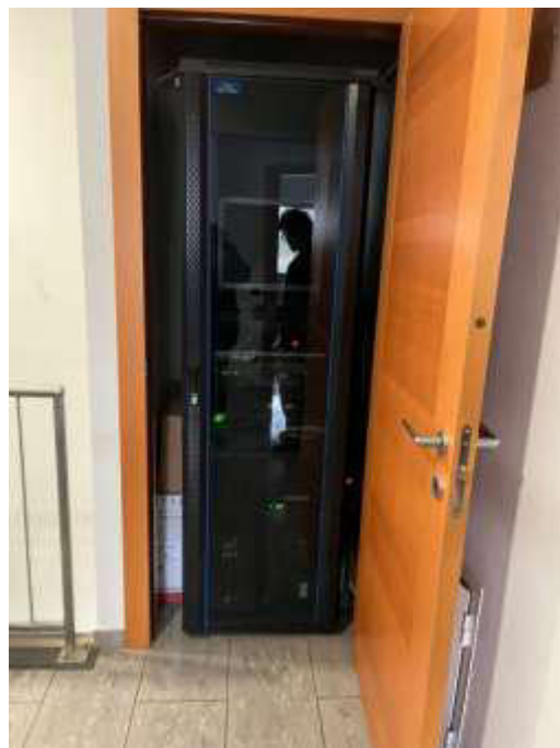
FOTO 34 Vista Quadro Elettrico Primo 1°
