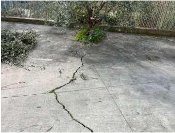
FOTO 81 Vista criticità lato sud
