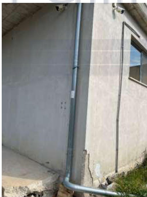
FOTO 79 Vista criticità lato sud
