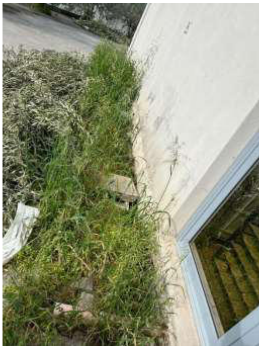
FOTO 85 Vista criticità lato sud
