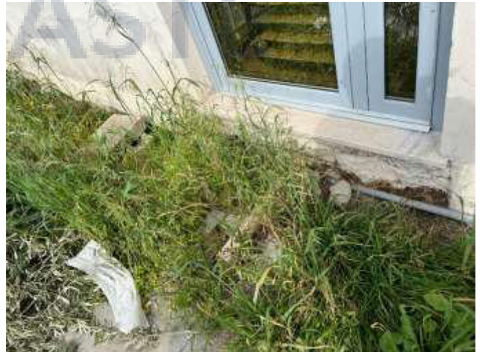
FOTO 84 Vista criticità lato sud
