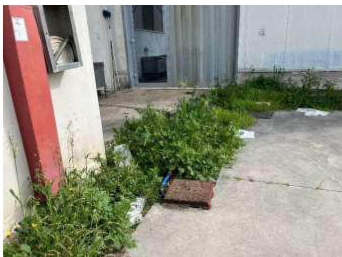
FOTO 89 Vista criticità lato sud
