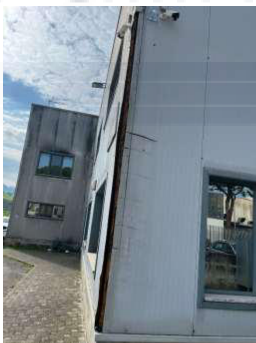
FOTO 91 Vista criticità lato sud
