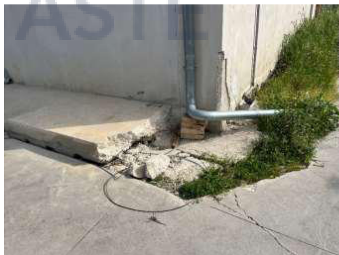
FOTO 80 Vista criticità lato sud
