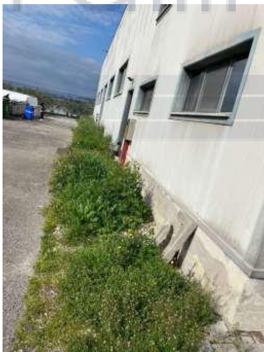
FOTO 71 Vista criticità lato sud
