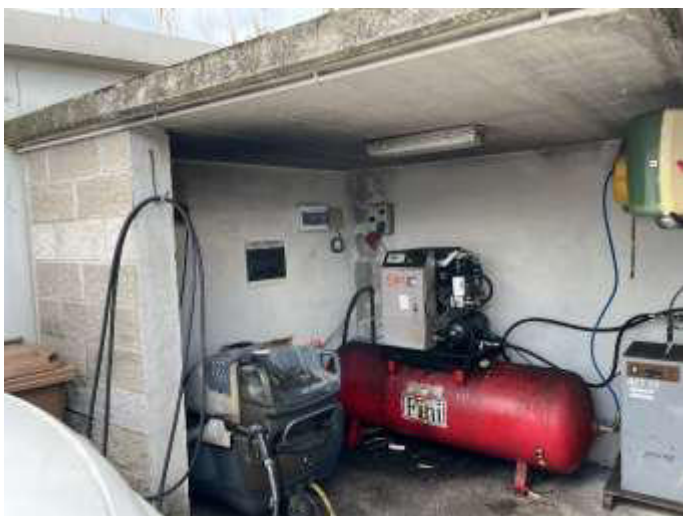
FOTO 61 Vista locale compressore
