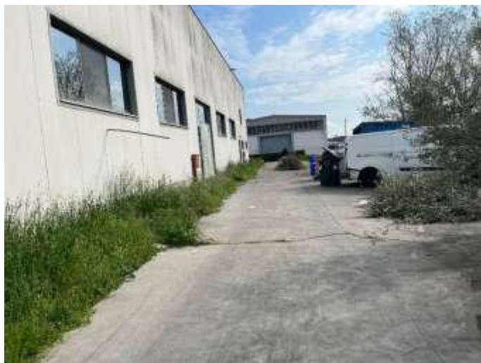
FOTO 70 Vista criticità lato sud
