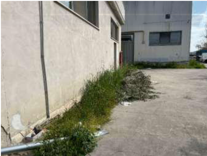
FOTO 83 Vista criticità lato sud
