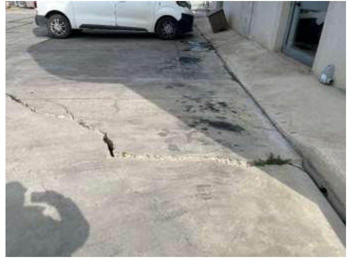
FOTO 82 Vista criticità lato sud
