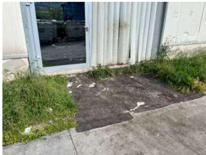
FOTO 78 Vista criticità lato sud
