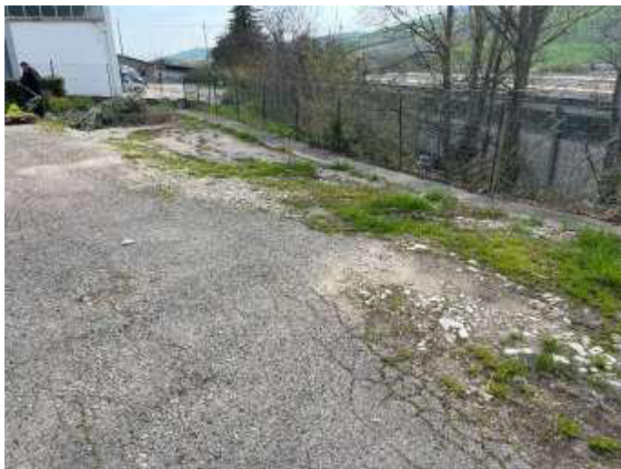
FOTO 77 Vista criticità lato sud
