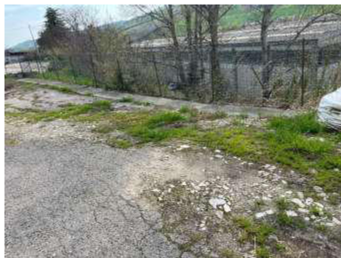
FOTO 74 Vista criticità lato sud
