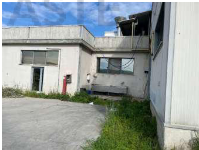
FOTO 72 Vista criticità lato sud
