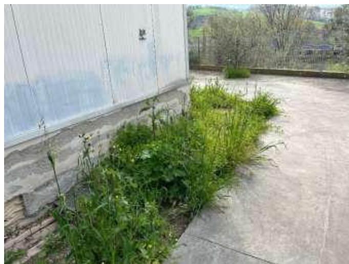
FOTO 86 Vista criticità lato sud
