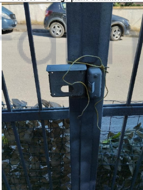
Foto 39 - Dettaglio serratura manomessa cancello carrabile
