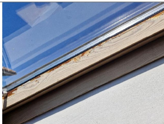
Foto 32 -Dettaglio Velux rovinata locale sottotetto
