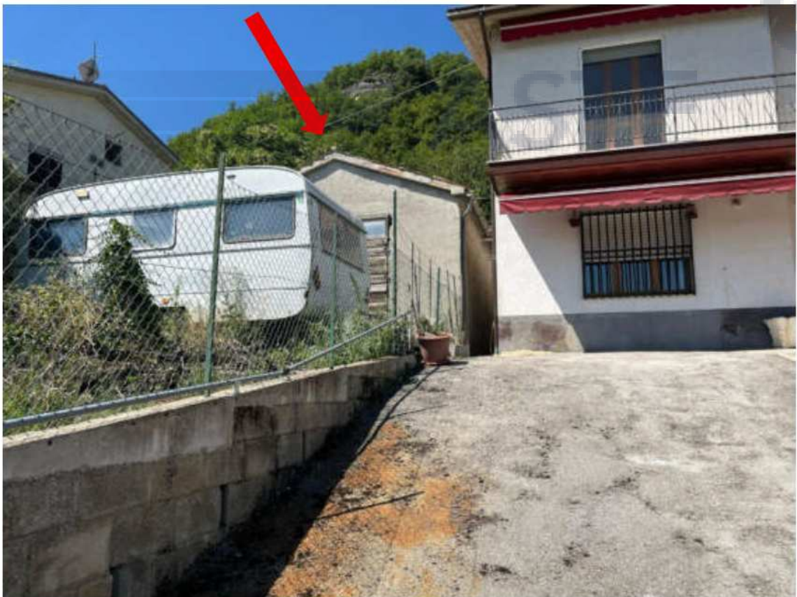
Foto 33 Sub. 5 Manufatto Inagibile
