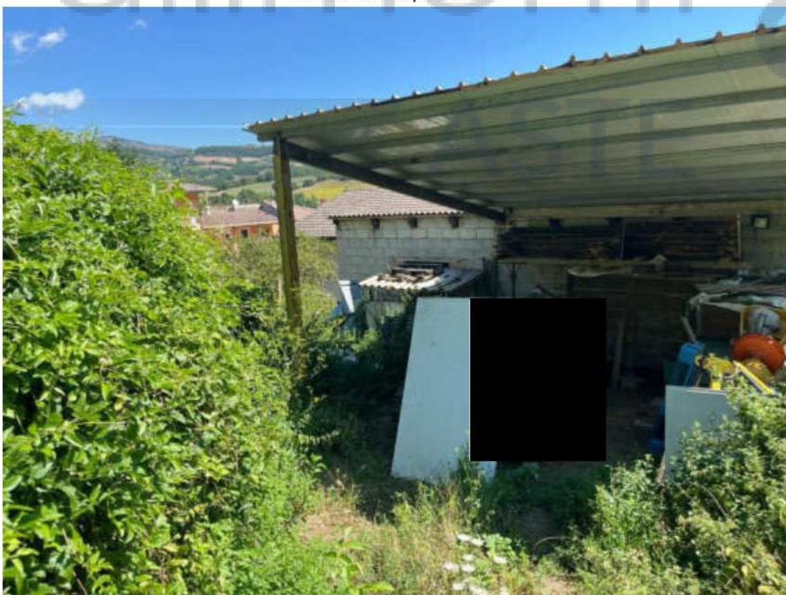
Foto 30 Tettoia posticcia C e manufatto abusivo B
