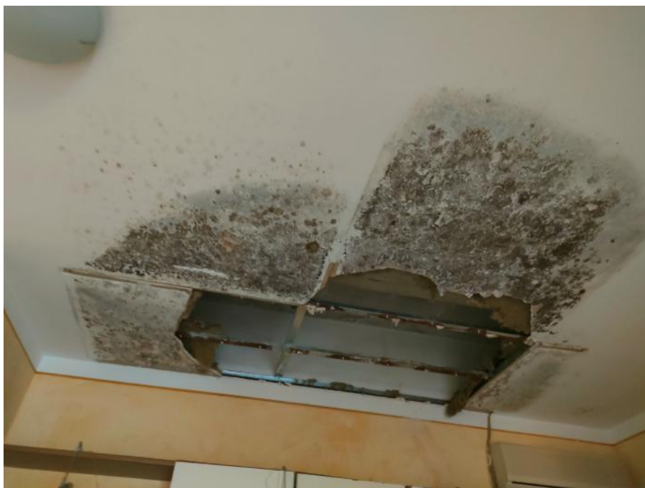
Particolare controsoffitto danneggiato Intervento di ripristino e/o eventuale rimozione a cura dell'aggiudicatario
