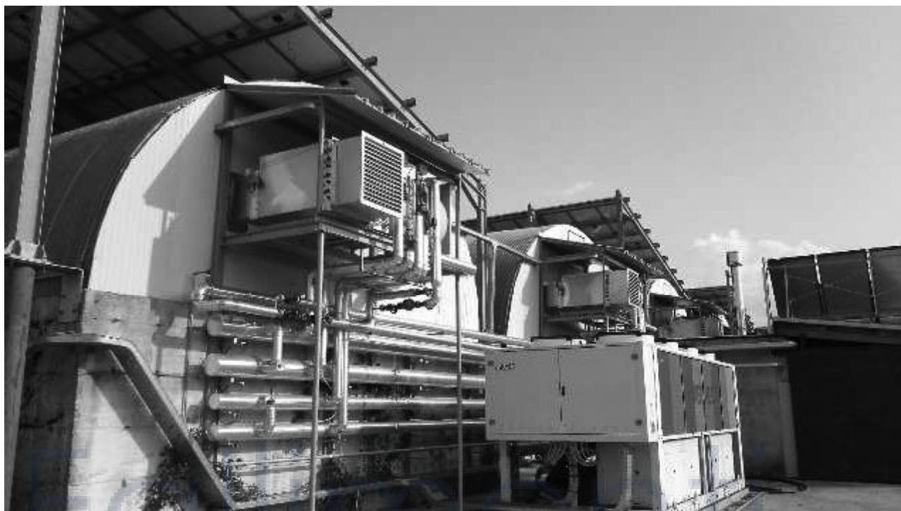
Impianto microclima per serre fungaia
