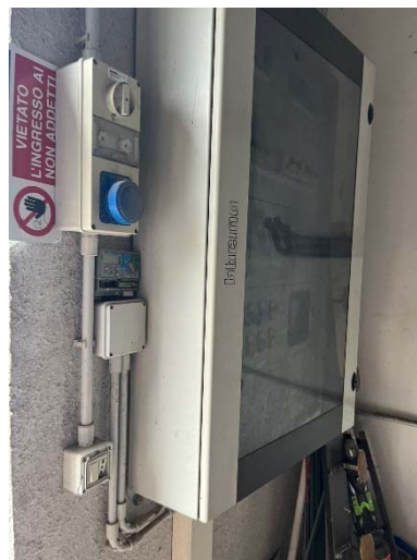
FOTO 130 Vista interno locale C.T.
