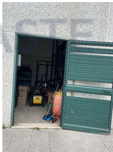
FOTO 20 Vista locale C.T.
