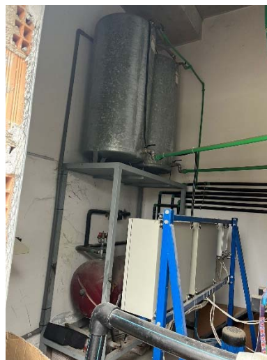
FOTO 126 Vista interno locale C.T.
