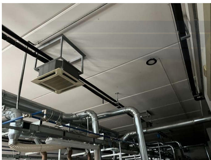
FOTO 79 Vista interno impianto tecnologici
