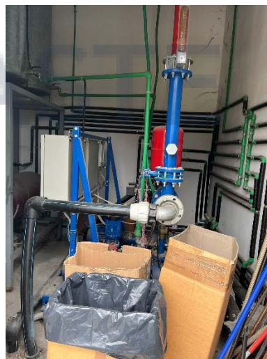
FOTO 128 Vista interno locale C.T.
