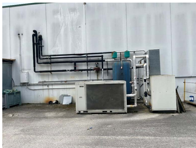
FOTO 10 Vista impianti su lato Nord
