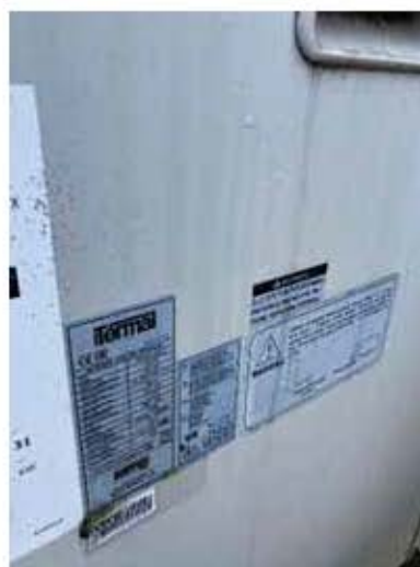
TARGA CE IMPIANTO CONDIZIONAMENTO
