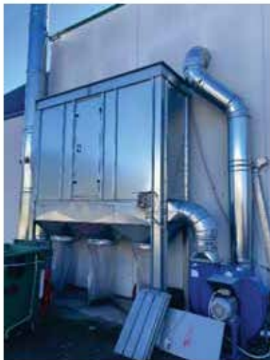
IMPIANTO DI ASPIRAZIONE (FILTRO A MANICHE)
