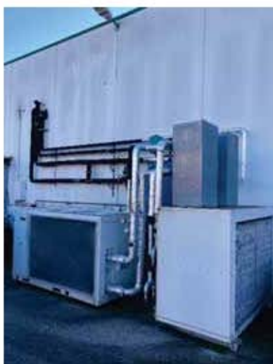
IMPIANTO DI CONDIZIONAMENTO (CHILLER)
