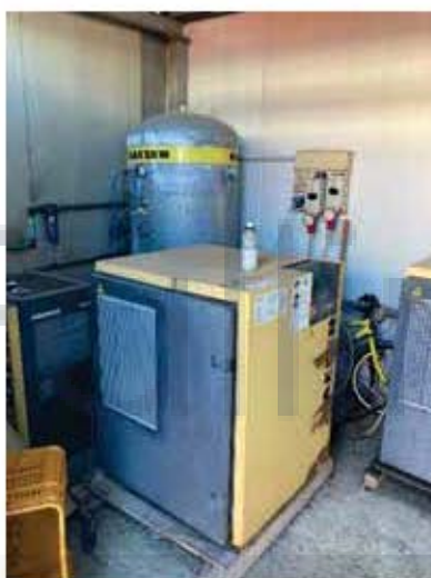
COMPRESSORE – ESSICCATORE ARIA - SERBATOIO
