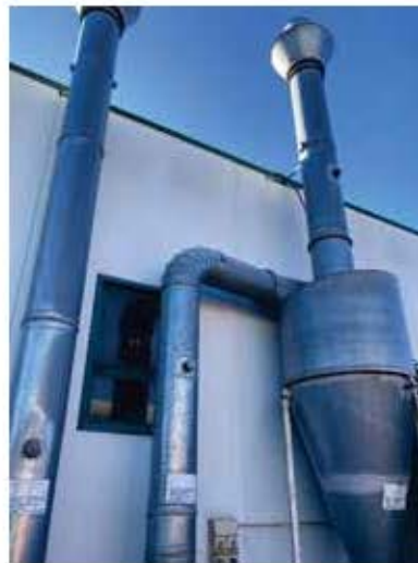
IMPIANTO DI ASPIRAZIONE (CICLONE)
